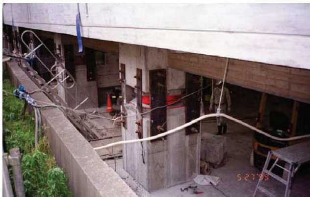
免震装置が取り付けられた柱
