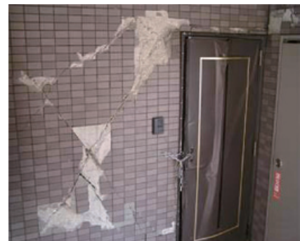
玄関ドアと RC 非構造壁の被害
