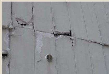
外壁(仕上材)の損傷
