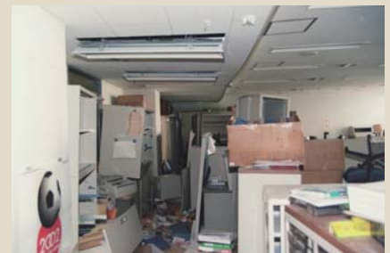
家具の転倒による建物機能の損失 (写真提供・神戸市)
