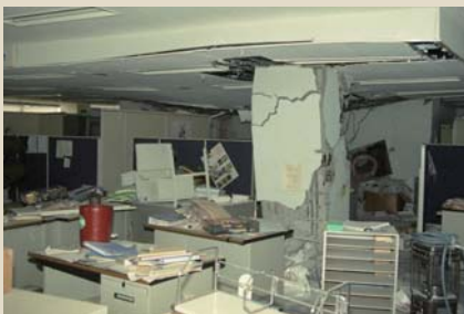
建物骨組の損傷 (写真提供・神戸市)
